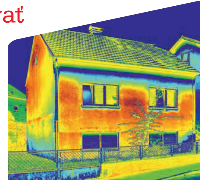
Príklad termovíznej snímky rodinného domu pred zateplením. Červené a oranžové miesta ukazujú oblasti veľkých tepelných strát, tzv. tepelných mostov.
